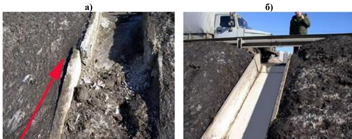
Рисунок 2. Результаты сравнительного испытания водоотводящих лотков 3 : (а) лоток из железобетона; (б) лоток из композиционного материала
